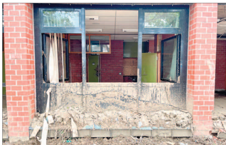
Die durch die Unwetterkatastrophe zerstörte »Levana«-Schule.
